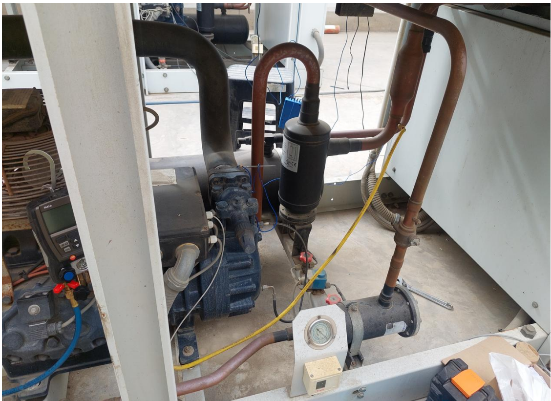
ANEXO N°3.4 instalación de equipos de medición Fuente. Planta Araexport SAC.
