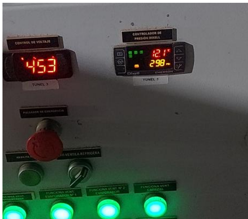
ANEXO N° 3.5 Vista de unidad condensadora en operación
