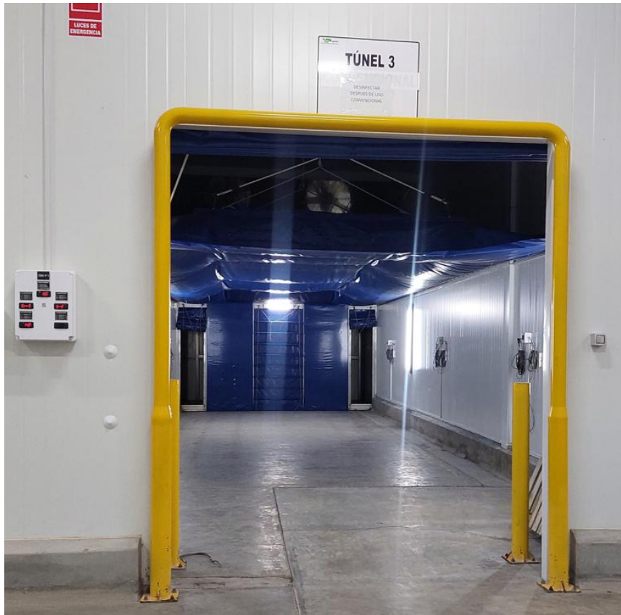
ANEXO N° 3.5 Vista interior de Túnel de enfriamiento N°03
