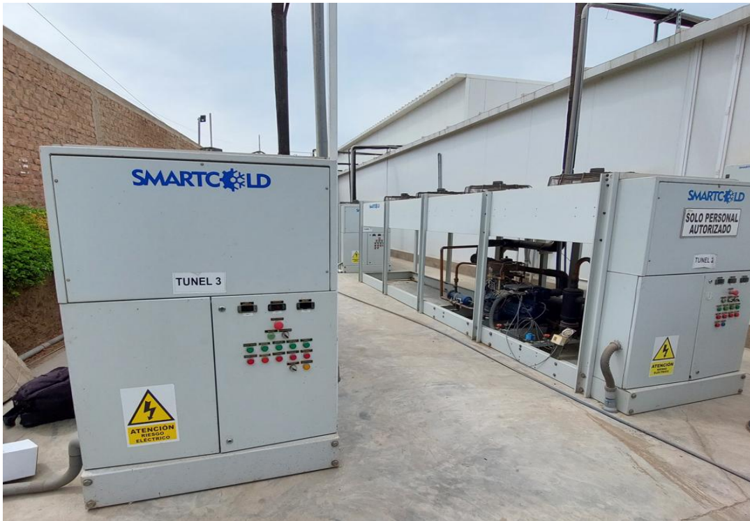
ANEXO N°3.1 Unidad condensadora de túnel N°03
