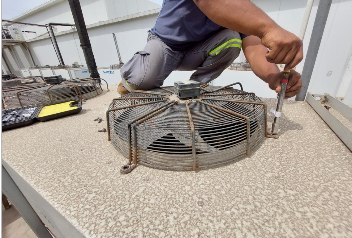
ANEXO N°3.2 Remplazo de ventiladores AC por EC en túnel N°03
