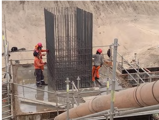
Figura 33. Instalación de acero de primera altura en pedestal P-2 en Nave de Palanquillas.
