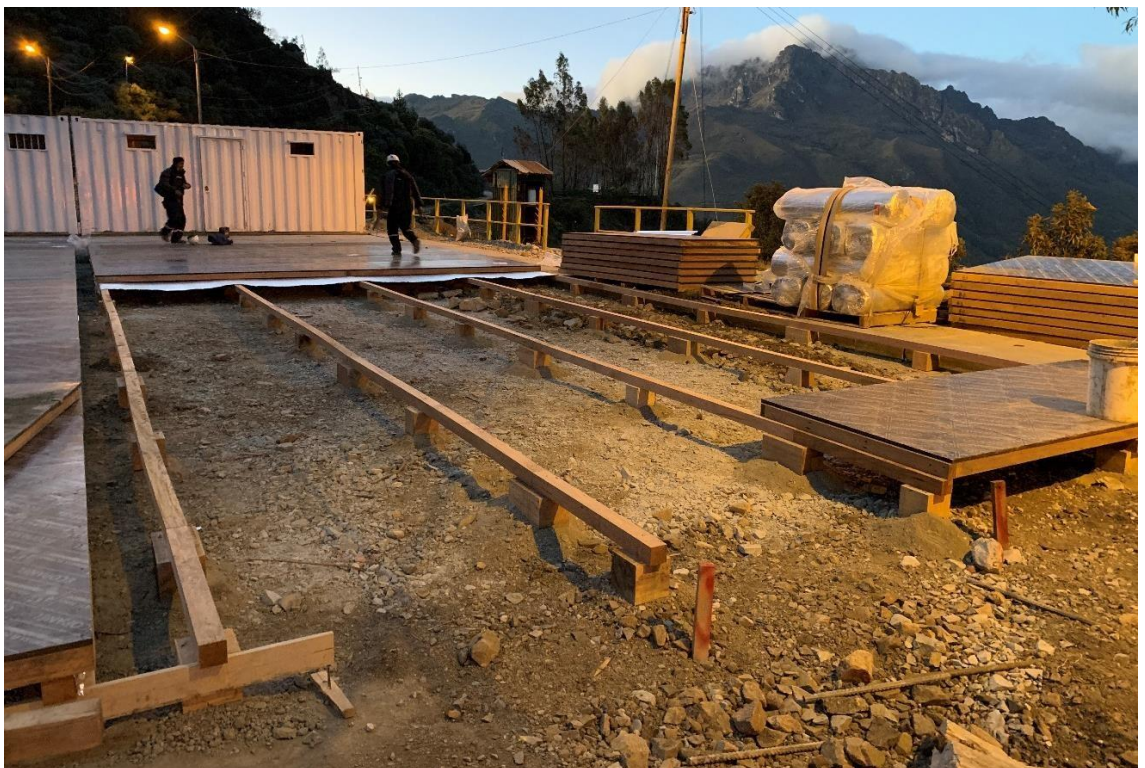
Figura 19. Zona 01 - Sub-Estación (04 Iglús) Inicio de montaje acorde a tren de trabajo. Fuente: Elaboración Propia
