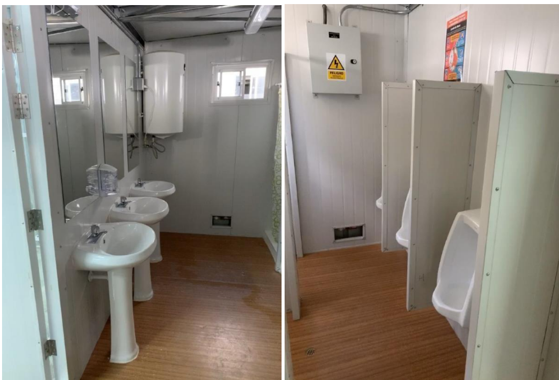
Figura 31. Vista interna baterías de baños. Fuente: Elaboración Propia
