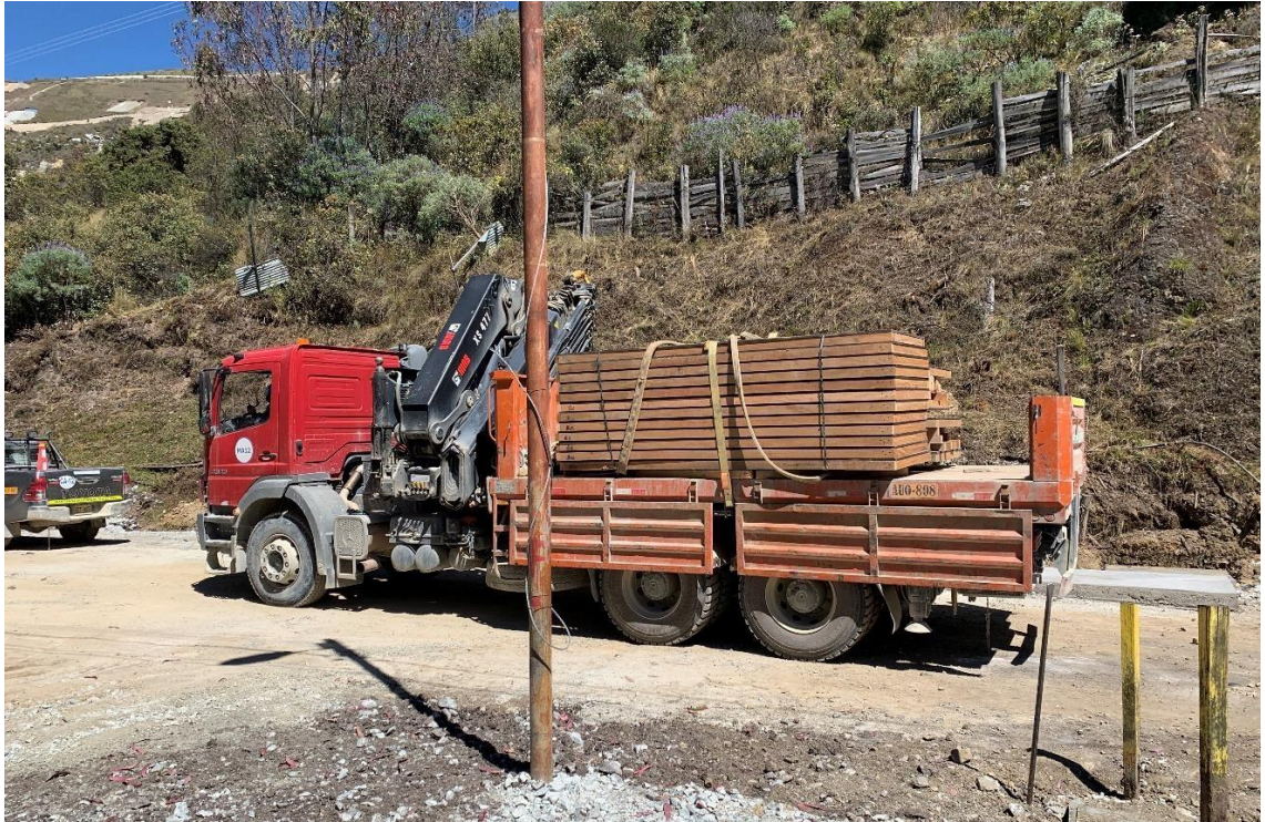
Figura 26. Zona 03 - Chilcas Oeste (05 Iglús) Movilización de elementos, materiales, procura. (Fuente: Elaboración Propia)
