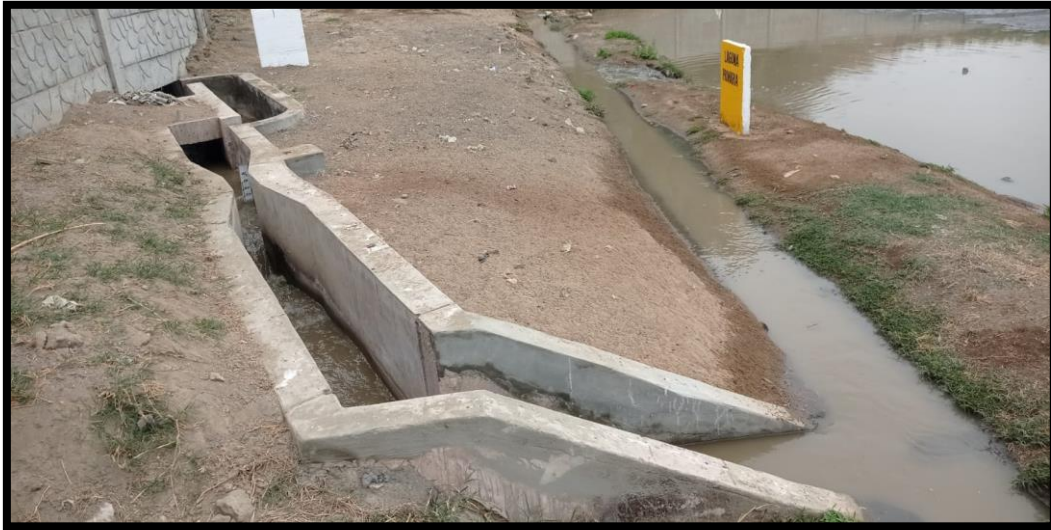
Figura 10: Canaleta Parshall al ingreso de la laguna facultativa
