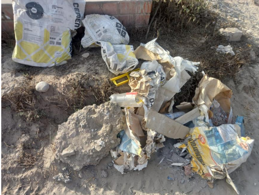
Figura N°12. Residuos Sólidos en la vía pública dejados a la intemperie
