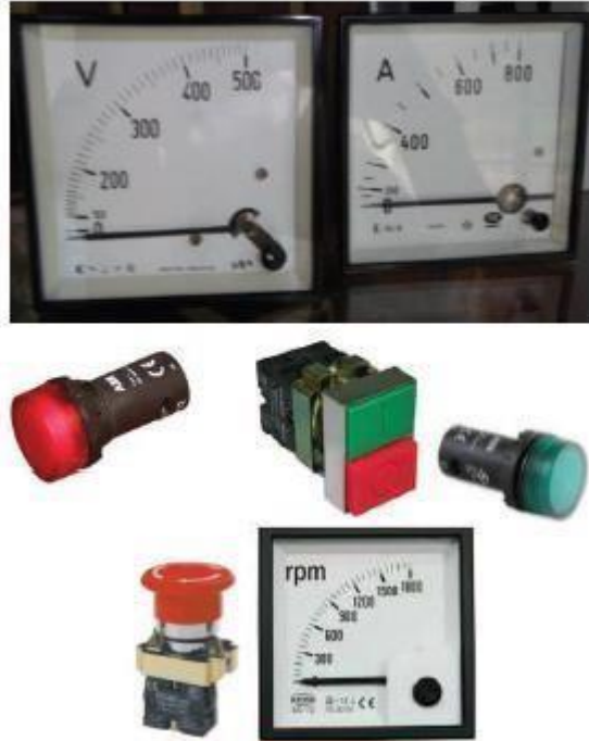
Fig. 58 Aparatos de medición, pulsadores y luces piloto en la consola de mando a distancia.
