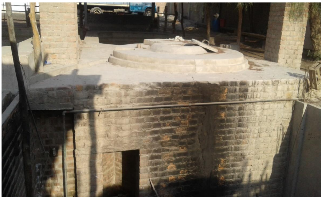
Figura 5.9 Grieta que atraviesa la paila y el muro de protección frontal.
