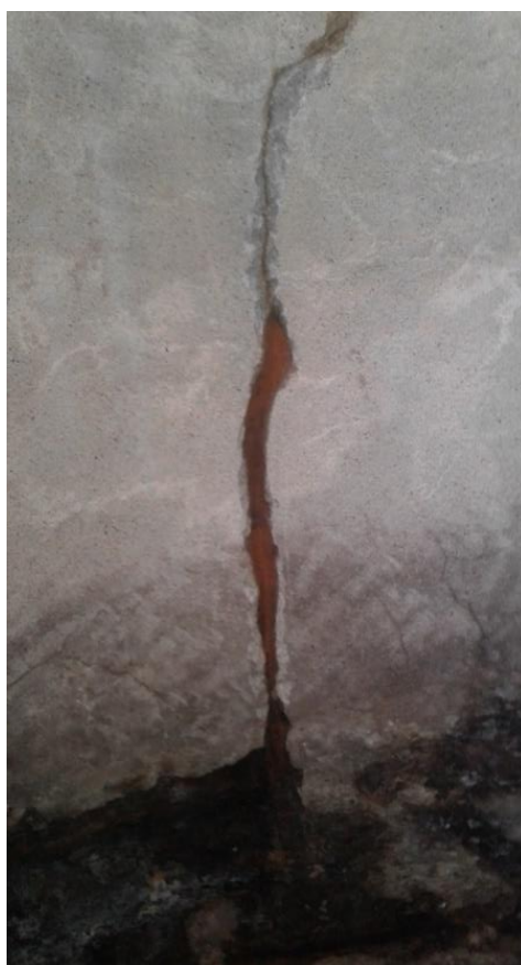
Figuras 5.10 Fisura en interior de la paila.
