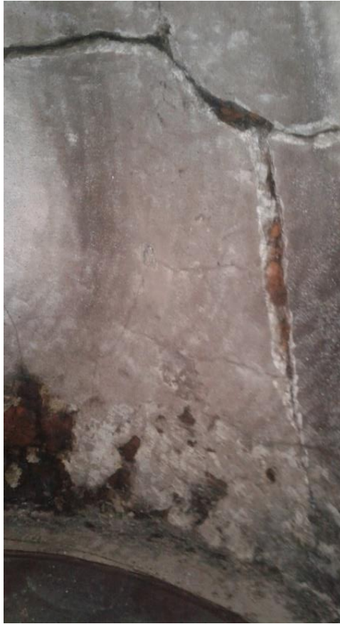
Figuras 5.11 Fisura en interior de la paila.
