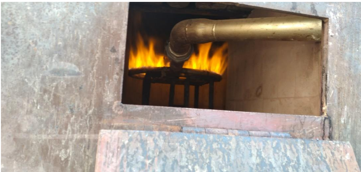
Figura 5.26 Horno con combustible gas natural.
