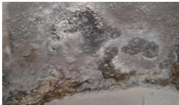
Figuras 5.23 Tarrajeo interior deteriorado.
