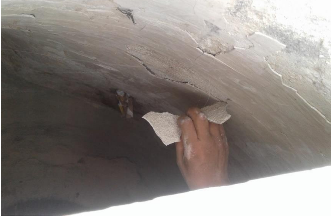
Figura 5.18 Capa de cemento despegándose en el tarrajeo interior.
