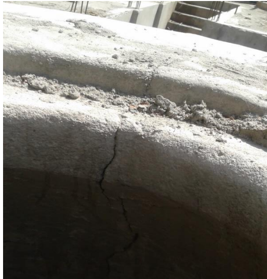
Figura 5.7 Grieta en la boca de la falca.
