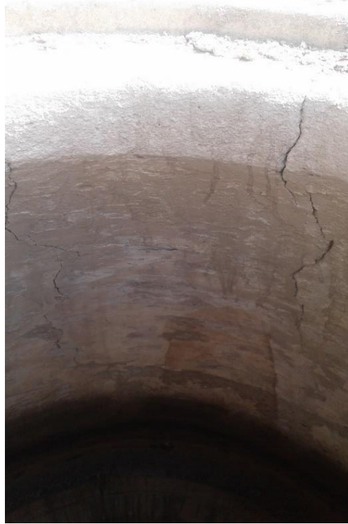
Figuras 5.21 Tarrajeo interior deteriorado.
