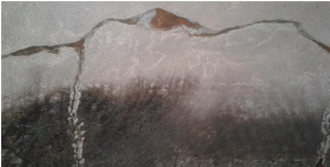
Figura 5.12 Fisuras en interior de la paila.
