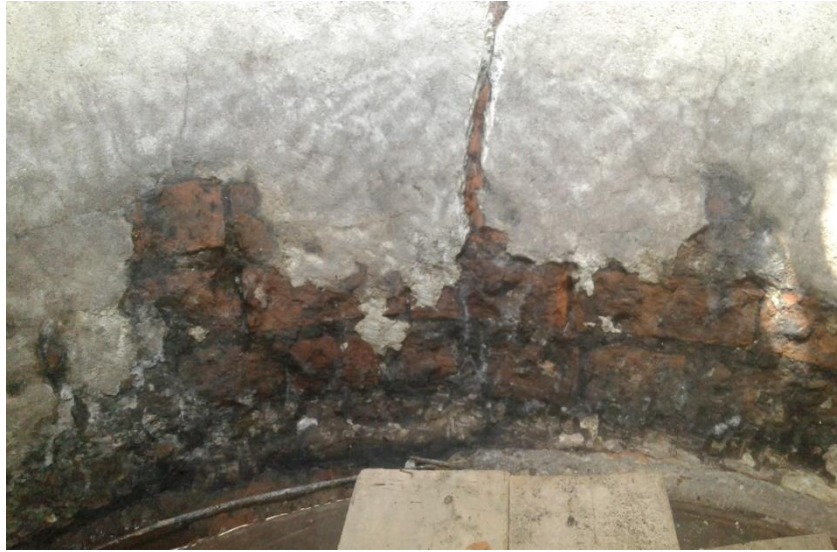
Figura 5.19 Tarrajeo interior deteriorado.
