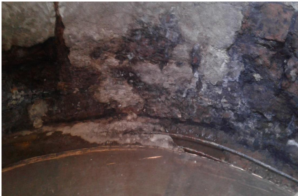
Figura 5.20 Tarrajeo interior deteriorado.
