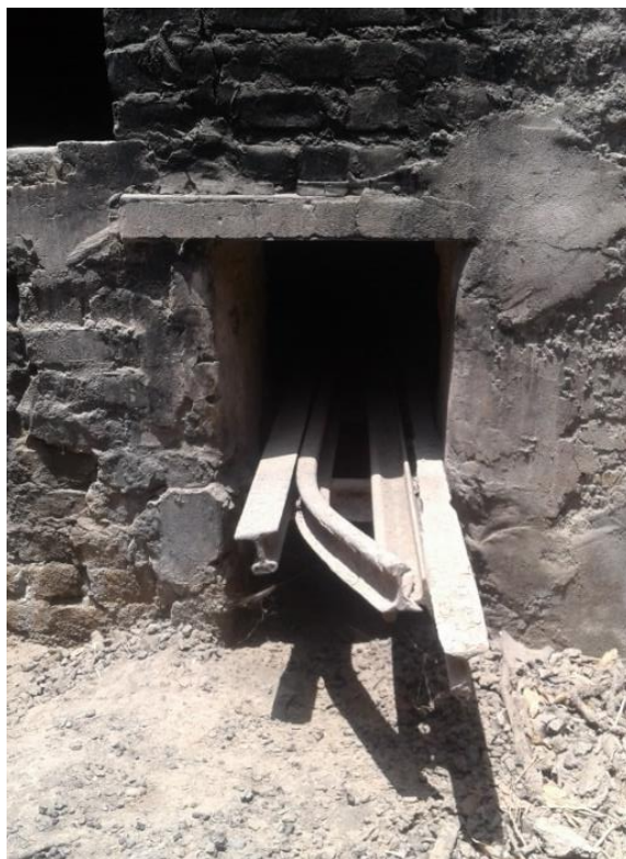
Figura 5.16 Boca de horno inadecuada.
