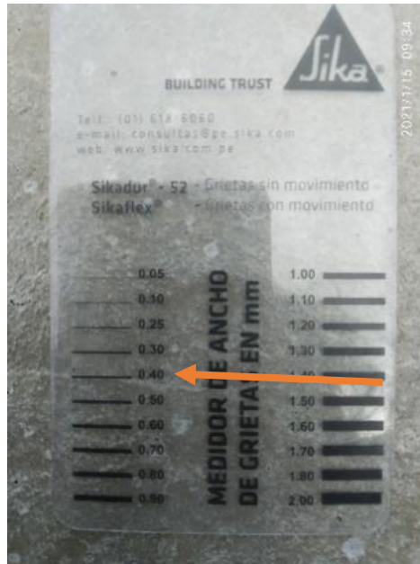
Imagen 21 Fisura de 0.4 medido con la regla de fisura con una resistencia de 140kg/cm 2 Patrón
