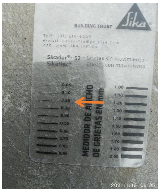
Imagen 19 Fisura de 0.25 medido con la regla de fisura con una resistencia de 140kg/cm2 Patrón
