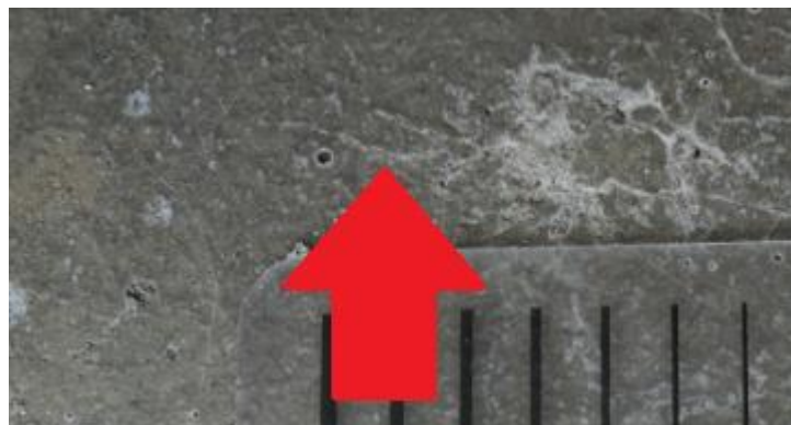
Imagen 22 Fisura de 0.1 con una resistencia de 140kg/cm 2 Patrón
