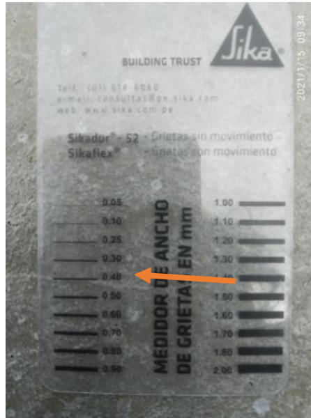
Imagen 27 Fisura de 0.4 medido con la regla de fisura con una resistencia de 140kg/cm2 Patrón
